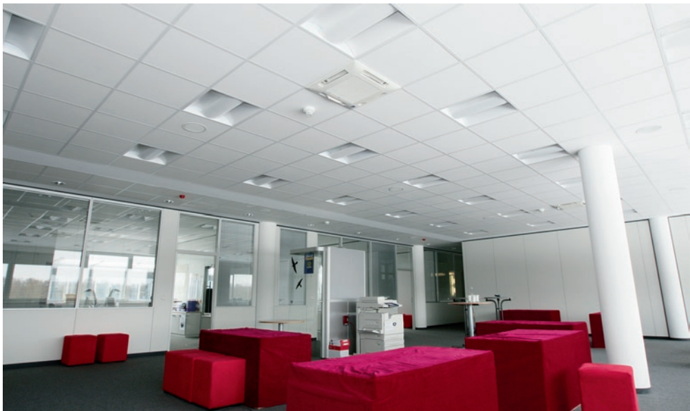
Abb. 5: Zur Klimatisierung der Komfortbereiche im Antenne Bayern-Gebäude werden Deckenkassettengeräte eingesetzt.
