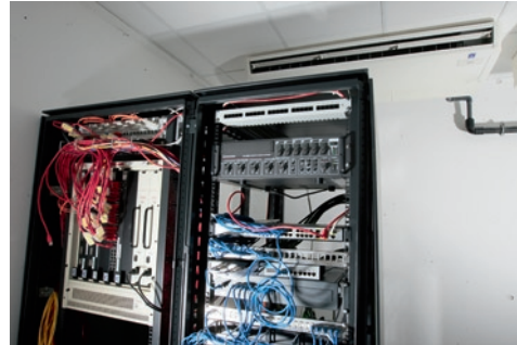
Abb. 3: Die Kühlung der kleinen Serverräume erfolgt über 2 Deckengeräte mit Kälteleistungen von je 12 kW.
